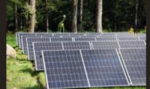
⑥ Panneaux photovoltaïques
